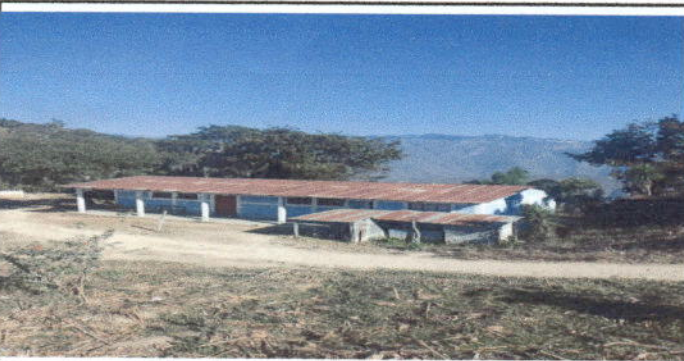
Foto 5: Pintura en mal estado
